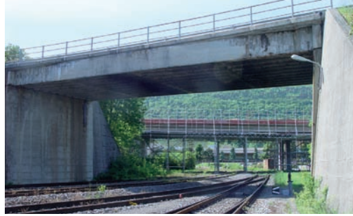
Pont dégradé, avant travaux. Verwitterte Brücke, vor den Arbeiten.
